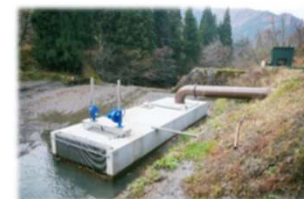
小水力発電施設
