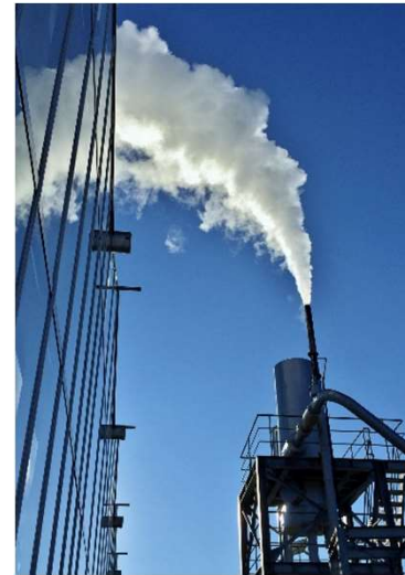
② 熱交換システムの一部（汽水分離器）から噴出する地熱（温泉）蒸気と農業ハウス
